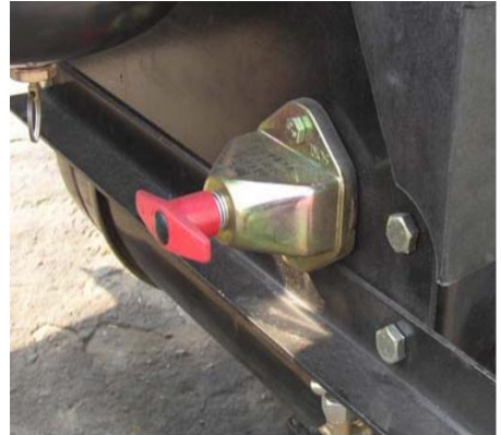
Interruptor mecánico de la batería (posición encendido)
